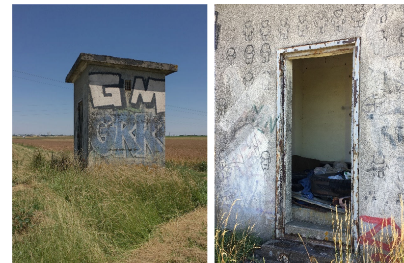
FIGURE 79 – INSPECTION DE LA RUINE DU POSTE TELECOM A L'ABANDON AU BORD DE LA RN20 (SOURCE : ING ENVIRONNEMENT)
